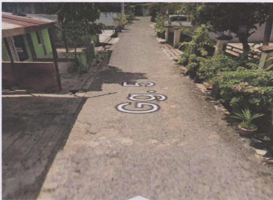
Kondisi Jalan di Jalan DR. Wahidin Sudiro Husodo Gang 5 RT.10 Kelurahan Dadimulya Kecamatan Samarinda Ulu Kota Samarinda
